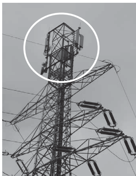
Rys. 6-4. Słup wsporczy elektroenergetycznej linii WN 110 kV z zamontowanymi antenami nadawczymi systemu telefonii komórkowej (fot. autorzy)
