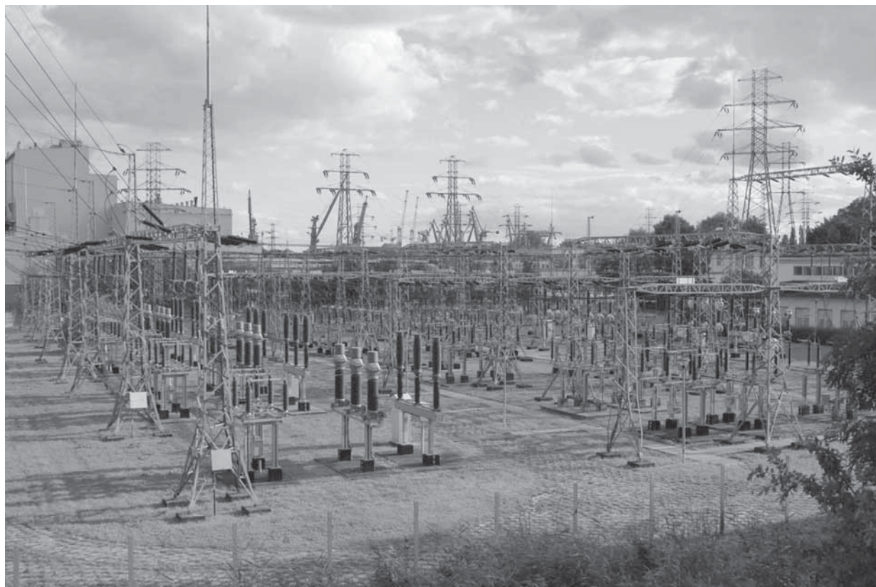
Rys. 3-3. Widok ogólny rozdzielni 110 kV
