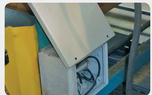
Fot. 1. Umożliwiony dostęp do wyposażenia elektrycznego podczas normalnej pracy linii
