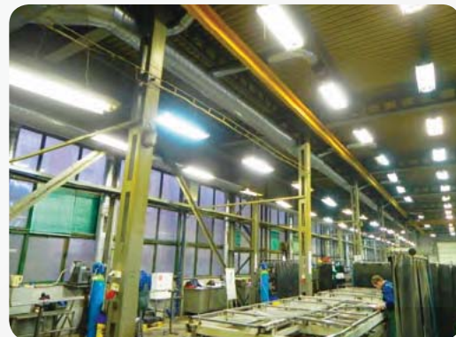
Fot. 3. Przykładowe rozwiązanie ogólnej wentylacji nawiewno-wywiewnej w hali spawalniczej Photo. 3. An example of push-pull ventilation in an industrial hall
