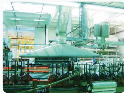
Fot. 2. Przykład zastosowanie okapu w procesie spawania Photo. 2. An example of the use of a canopy hood in a process enclosure
