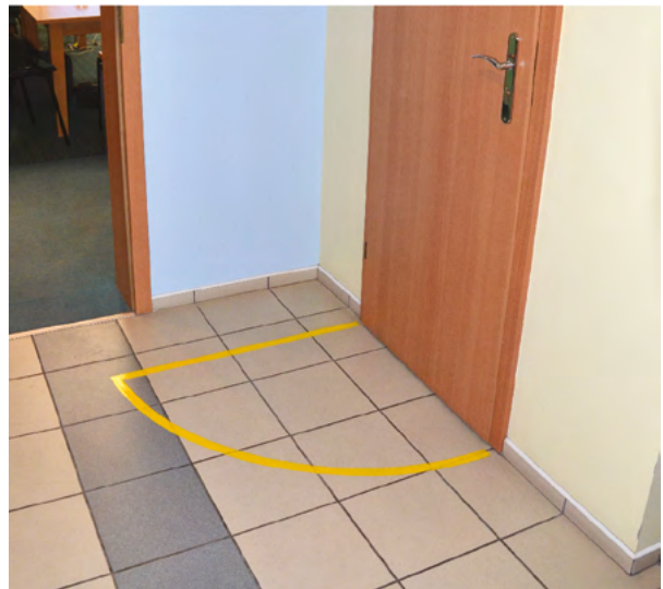
Rys. 2-54. Oznaczone na posadzce kierunki otwierania drzwi (źródło: CIOP-PIB)
