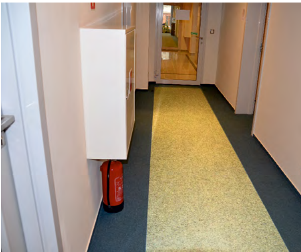
Rys. 2-40. Nieprawidłowo umieszczone: wisząca szafka ppoż. i stojąca pod nią gaśnica (źródło: CIOP-PIB)
