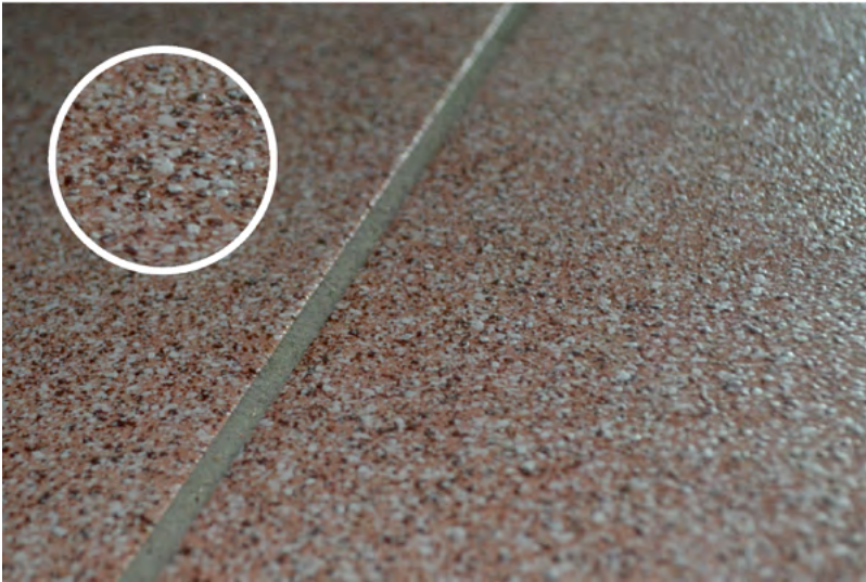
Rys. 2-45. Powierzchnia posadzki z materiału niepowodującego niebezpieczeństwa poślizgu, np. z terakoty, w pomieszczeniu higieniczno-sanitarnym dla osób niepełnosprawnych (źródło: CIOP-PIB)
