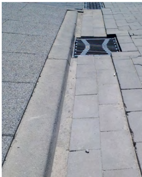
Rys. 2-30. Utrudnienie w postaci odkrytego kanału ściekowego i zagłębionego wpustu na styku jezdni i chodnika (źródło: CIOP-PIB)
