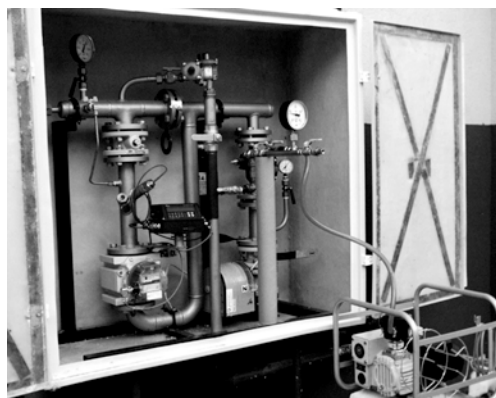
Stanowisko napełniania gazem metodą próżniową instalacji. Blok mieszkalny z kotłownią gazową w Ząbkach
